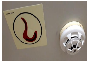
Gambar 3.2 Alat Deteksi kebakaran yang dapat berfungsi dengan baik dan akan dilanjutkan menuju panel control
