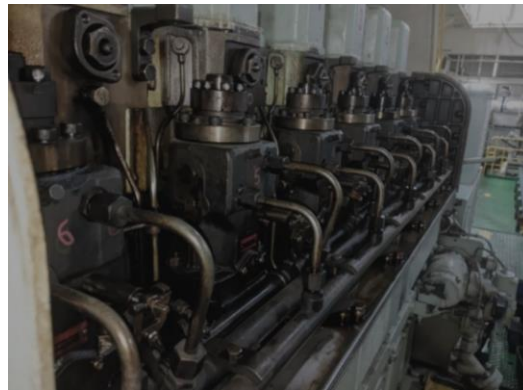
Gambar 1. Mesin diesel 4 tak pada generator di kapal MV. Radiant Reb
