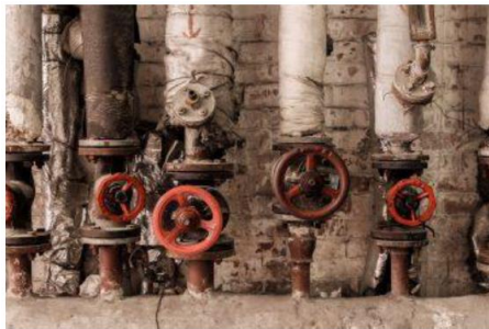
a. Insulasi pipa rusak
